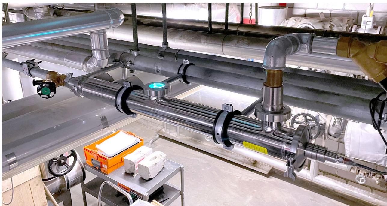
La mise en service d'appareils UVC sterilAir a eu un effet positif en peu de temps: la charge bactérienne a diminué progressivement.
