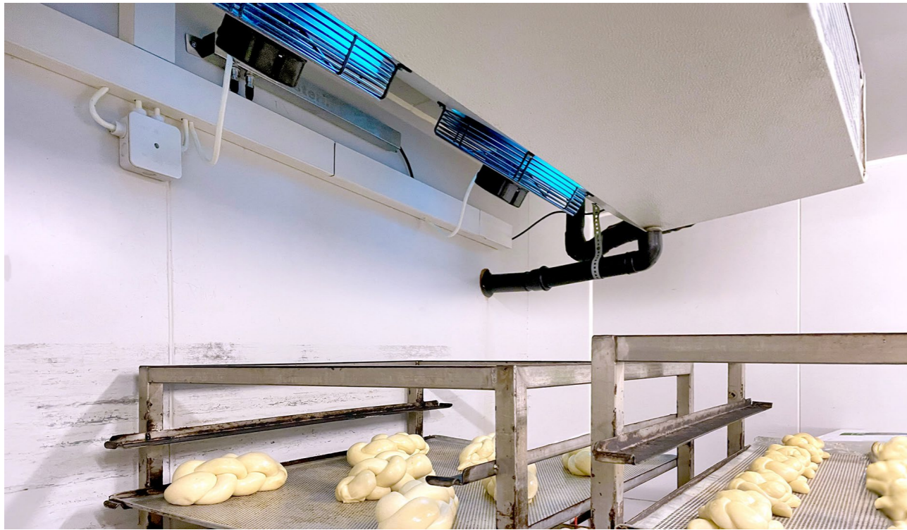
UVC-Entkeimung in einem Luftkühler sorgt für saubere Kühlregal und sichert die Luftqualität im Kühlraum
